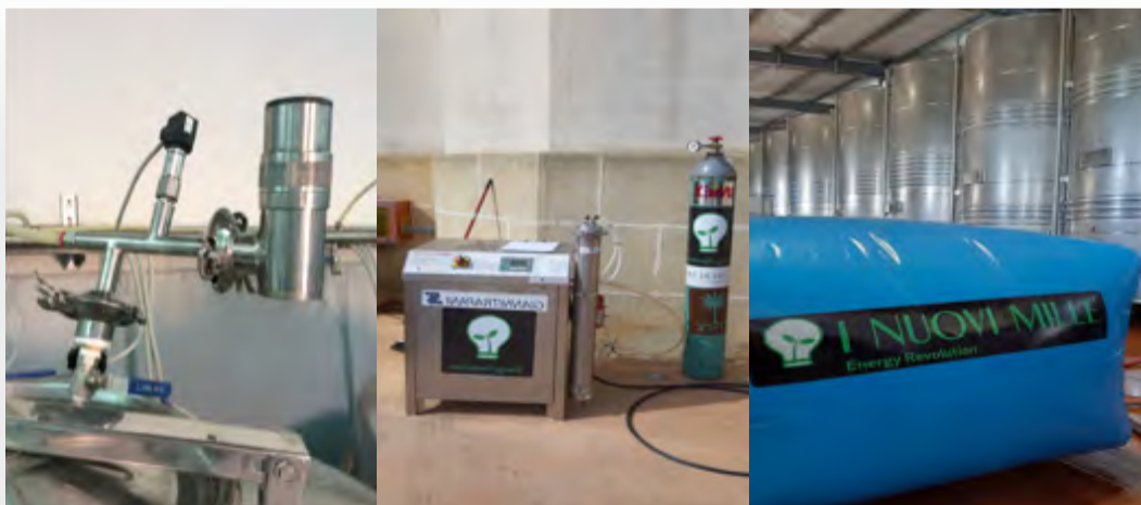
2 impianto di cattura CO2 di fermentazione
