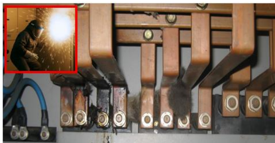
Figura 7.1.6 – Corpo estraneo sul sistema a sbarre
