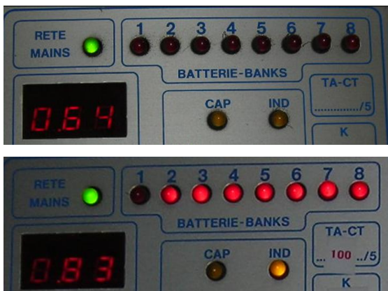
Figura 7.1.5 – Regolatori di potenza reattiva (app. rifasamento)
