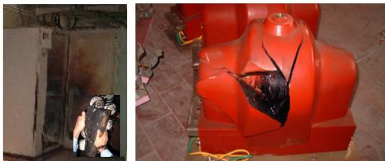
Fig. 7.2.8 – esempi di guasti causati dalle risonanze pericolose
